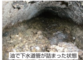
油で下水道管が詰まった状態
