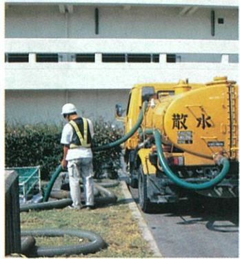
散水用水の取水状況
