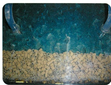
生物脱臭装置内
