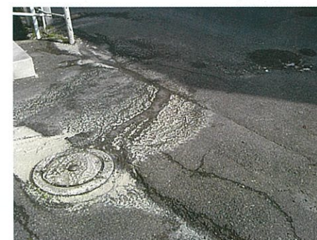
〈宅内ますから吹き出てる！〉
