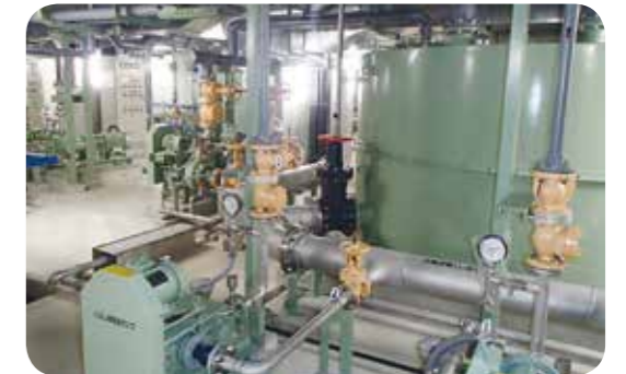
B1F ポンプ室
