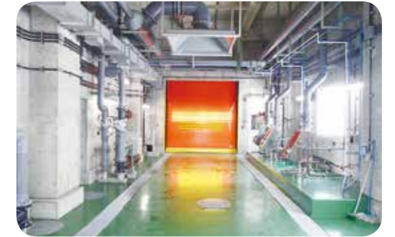
1F し尿・浄化槽汚泥受入室
