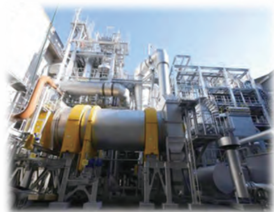
写真 湖西浄化センター汚泥燃料化施設
