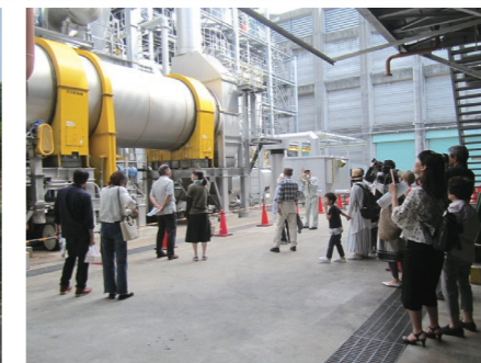
湖西浄化センター施設見学会(汚泥燃料化施設)
