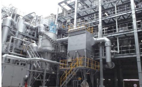
下水汚泥燃料化施設
