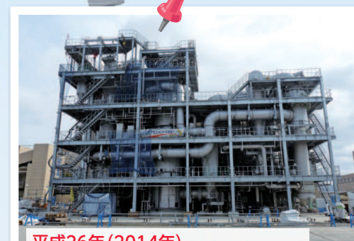
平成26年(2014年) 湖南中部浄化センター高効率二段燃焼方式焼却炉運転開始
