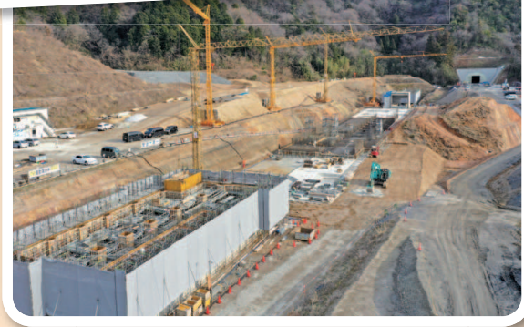
東北部浄化センター 膜分離活性汚泥法による省スペースで高効率な下水処理
