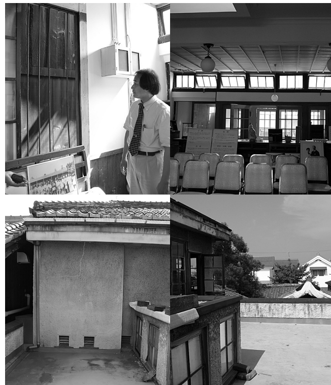
隣家との間の通気窓 旧八幡郵便局の内部から 2階の通気孔 ベランダからの風景
